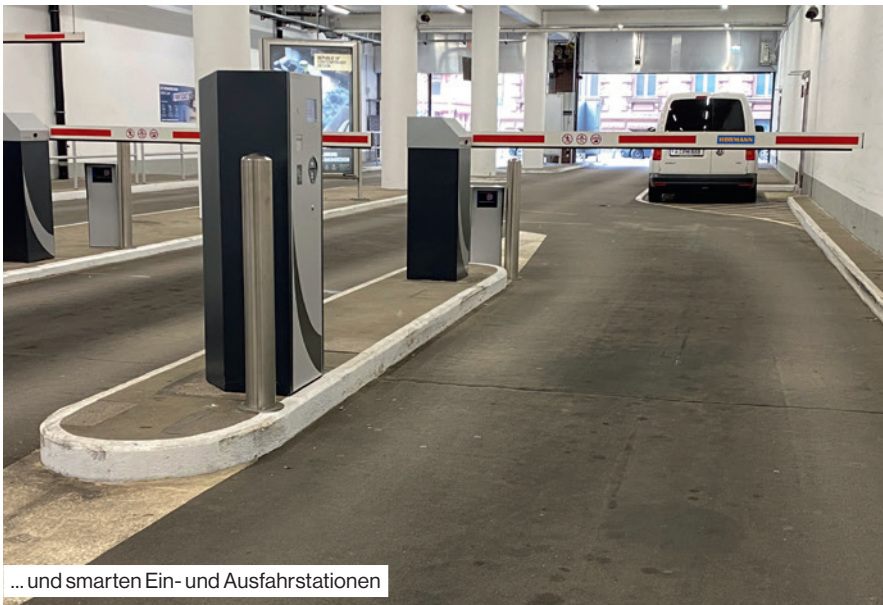
Das Parkraum-Management-System von Hörmann in einem öffentlichen Parkhaus mit Kassenautomat...
